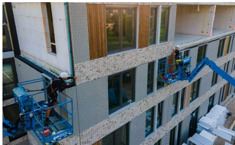
Voorbeeld nieuwe pui
