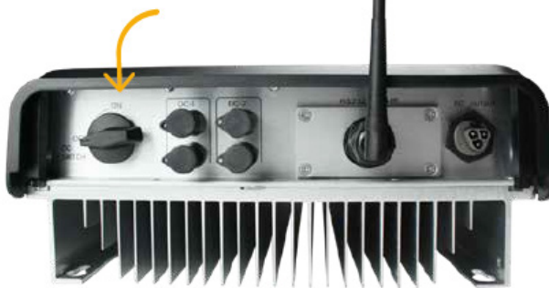
Foto 1 Voorbeeld DC schakelaar
